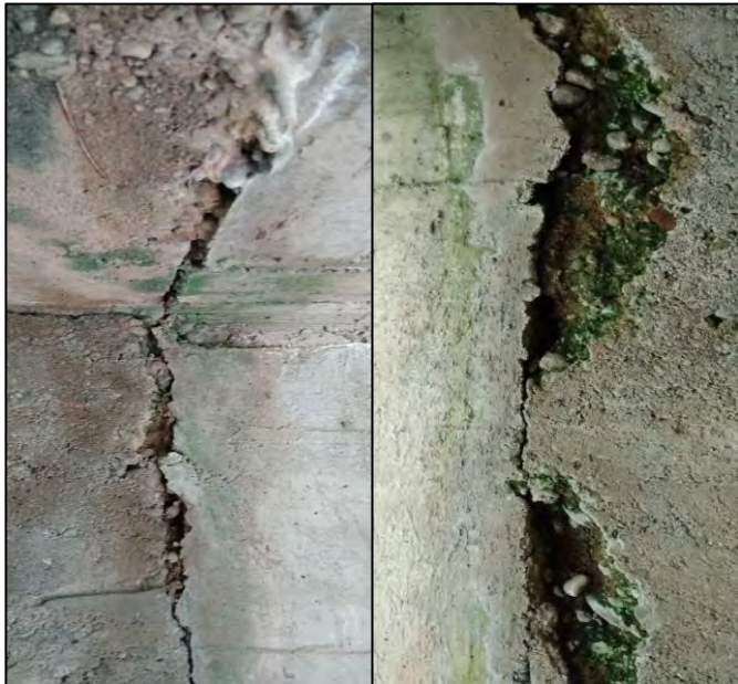
Abbildung 20: Risse unter der Brücke im Plangebiet in der Gemeinde Amerang (Mühl 26.02.2020)
